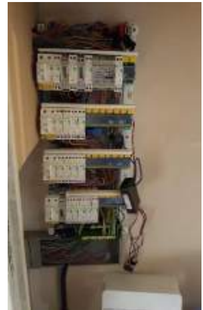
Figure 174 ci-contre : Illustration de la pose de pinces ampèremétriques dans le tableau électrique d'une maison.
