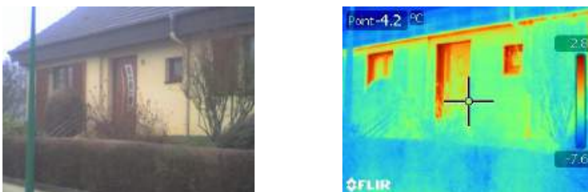
Figure 84 : Thermogramme de la liaison du mur avec les menuiseries en l'absence de retour d'ITE (rénovation par gestes).
