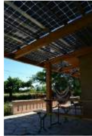
Installation photovoltaïque semi-transparente sur pergola bois
